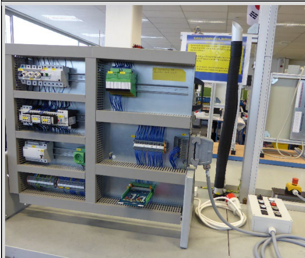
Prüfrahmen mit SPS Rückseite des Prüfrahmens mit montiertem Drehstrommotor und Bedientafel →
